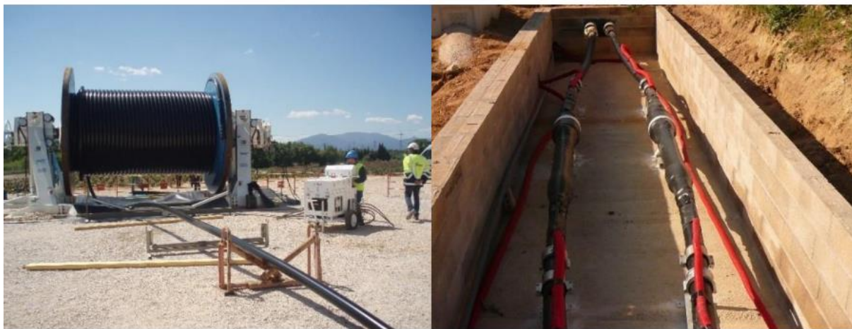
Figure 3 : Câble sur touret (à gauche) et chambre de jonction terrestre (à droite). Source : RTE
