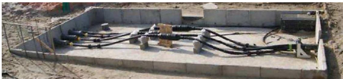
Figure 5 : Exemple d'une chambre d'atterrage avant son comblement
