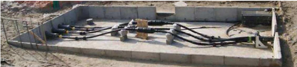
Figure 4 : Exemple d'une chambre d'atterrage avant son comblement
