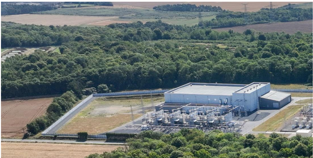
Figure 12 : Exemple d'une station de conversion à terre (IFA2 – Bellengreville - Calvados). Source : RTE.
