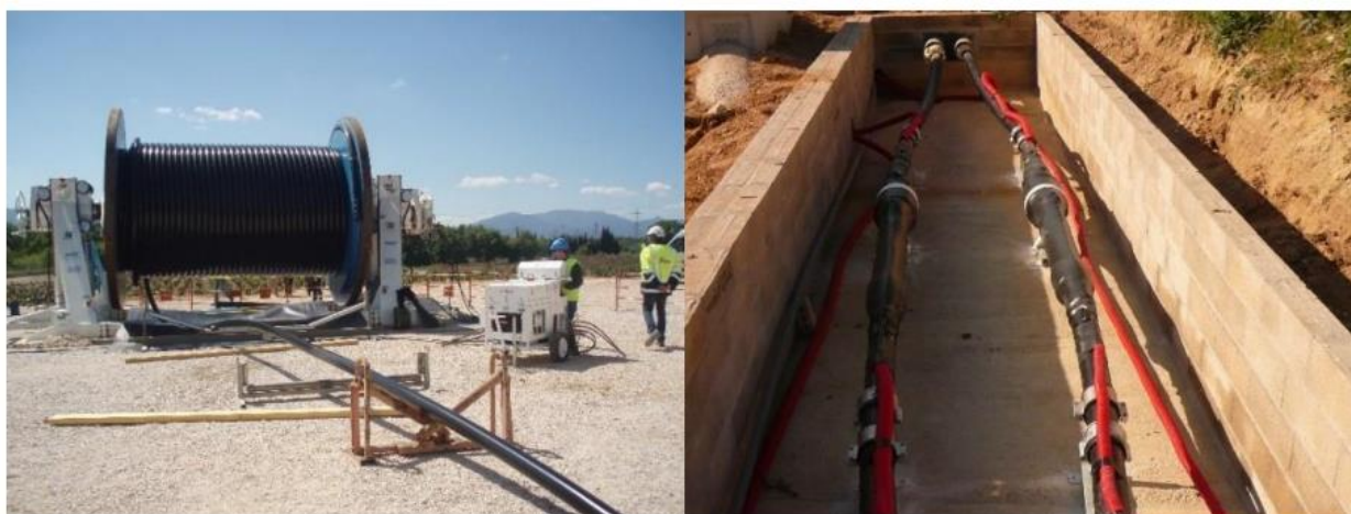
Figure 7 : Câble sur touret (à gauche) et chambre de jonction terrestre (à droite). Source : RTE
