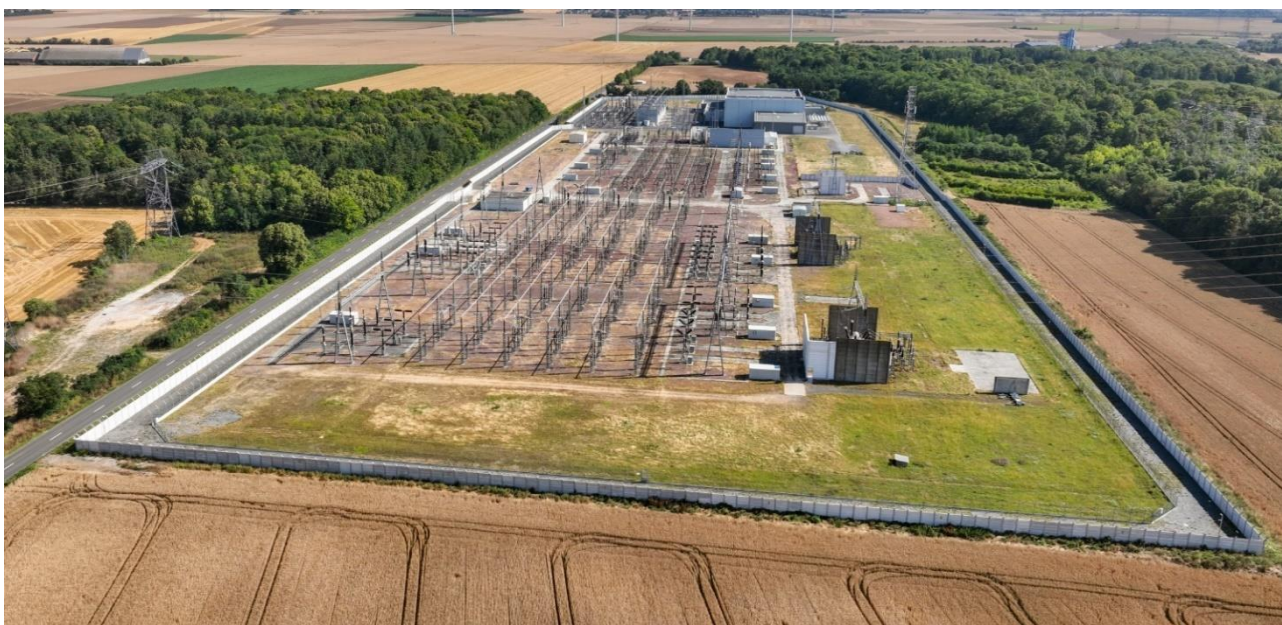
Figure 39 : Poste électrique de Tourbe existant. Source : RTE
