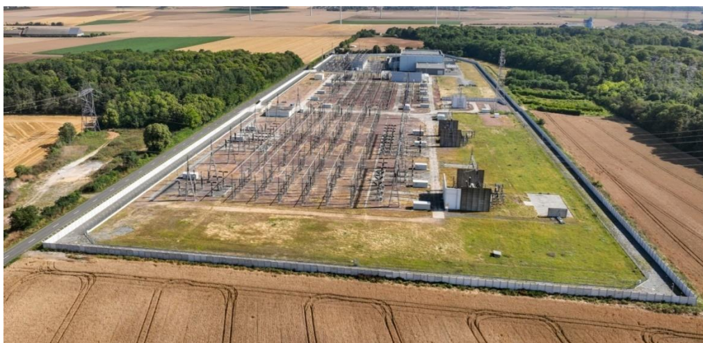
Figure 1 : Poste électrique de Tourbe existant. Source : RTE
